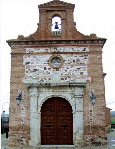
Iglesia del Santísimo Cristo San Salvador del Mundo (Calzada de Calatrava), s. XVI. En la base del edificio encontramos sillares de basalto y lapilli con y sin carbonatos.
